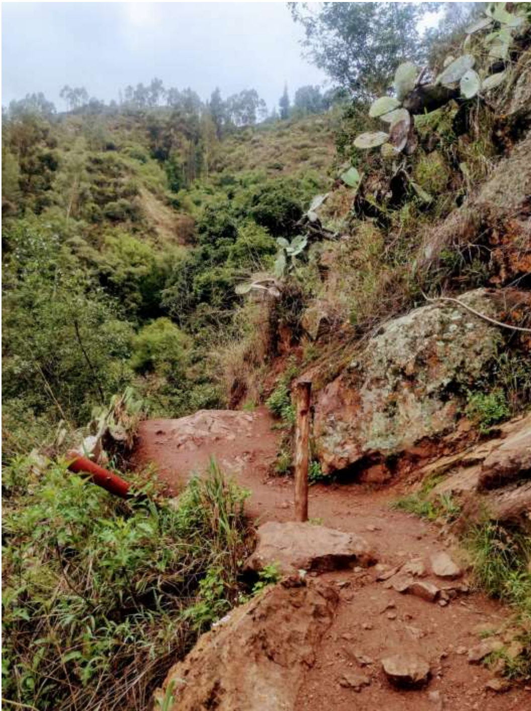
Fotografía 24: Falta de mantenimiento en el acceso a la cascada (Occhochaca).
