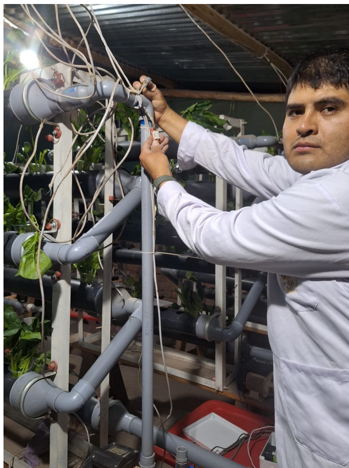
Figura C.9. Verificación de sensores y conexiones instaladas en el sistema NFT.
